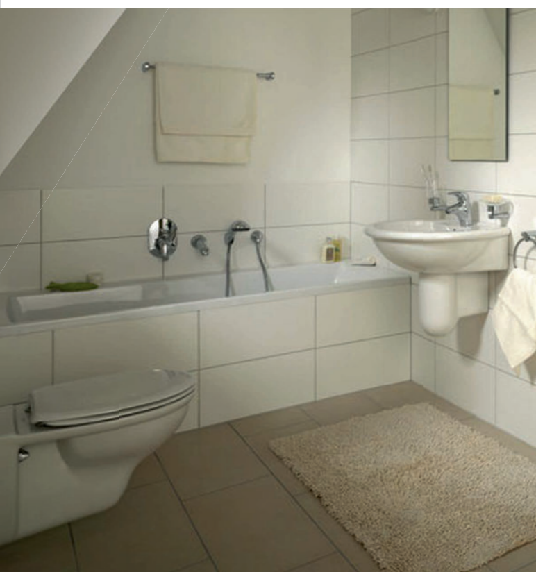
Vor dem Umbau - der hohe Wannenrand ist eine gefährliche Stolperfalle
